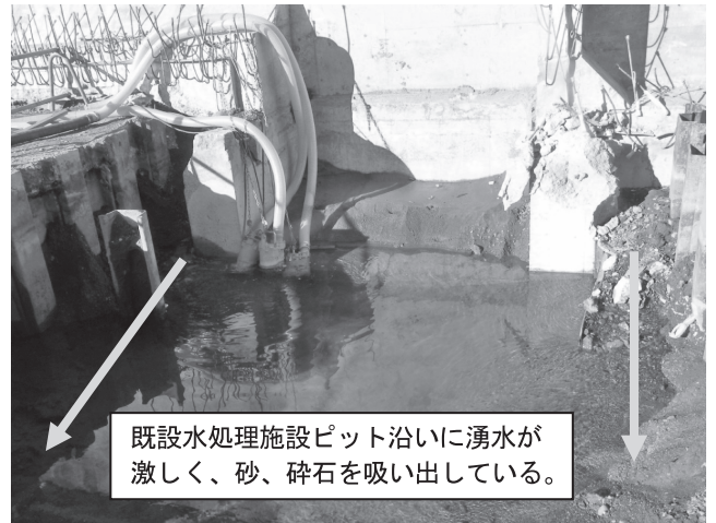
写真一3 水処理施設ピット部湧水状況
