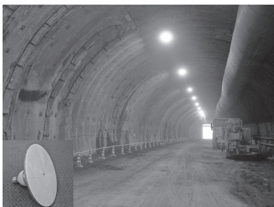
写真一2 坑内LED照明
