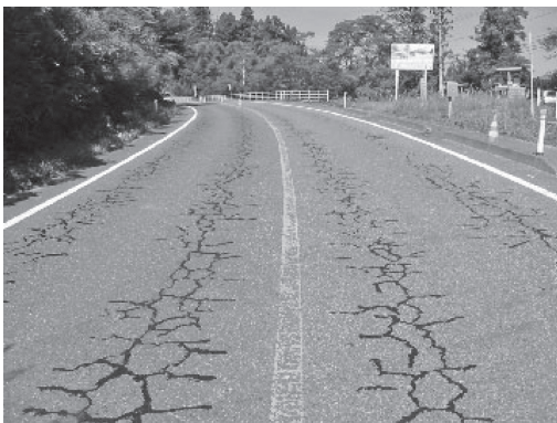
写真—10 路面状況（施工前）
