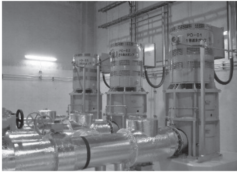
写真一七 送水ポンプ（金浜消雪基地機械室内）
