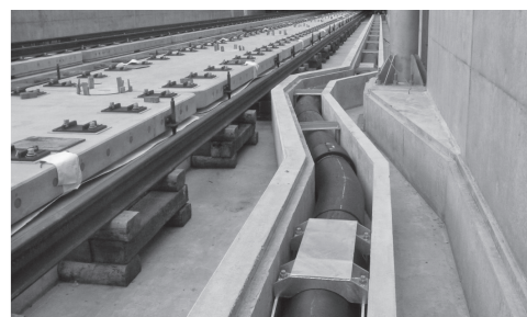
写真一〇 送水本管
