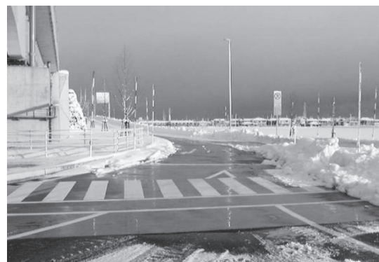
写真-3 地中熱ヒートポンプ方式の融雪状況
