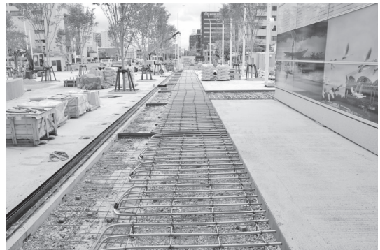
写真一4 地中熱ヒートパイプ方式の配管状況
