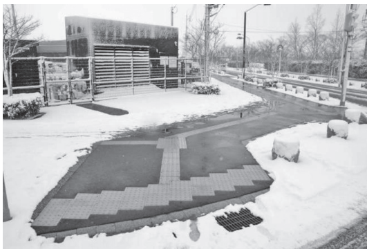
写真—6 空気熱ヒートポンプ方式の融雪状況
