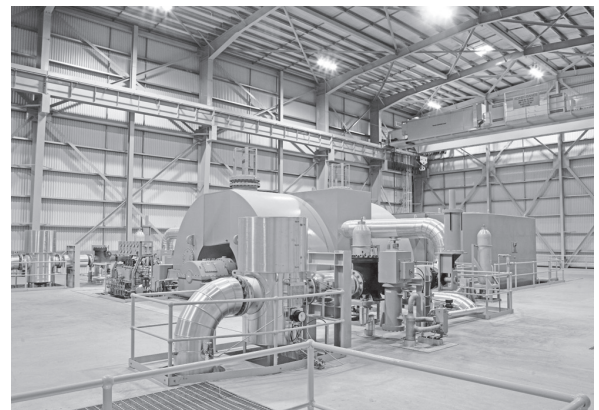
写真-2 蒸気タービン及び発電機
