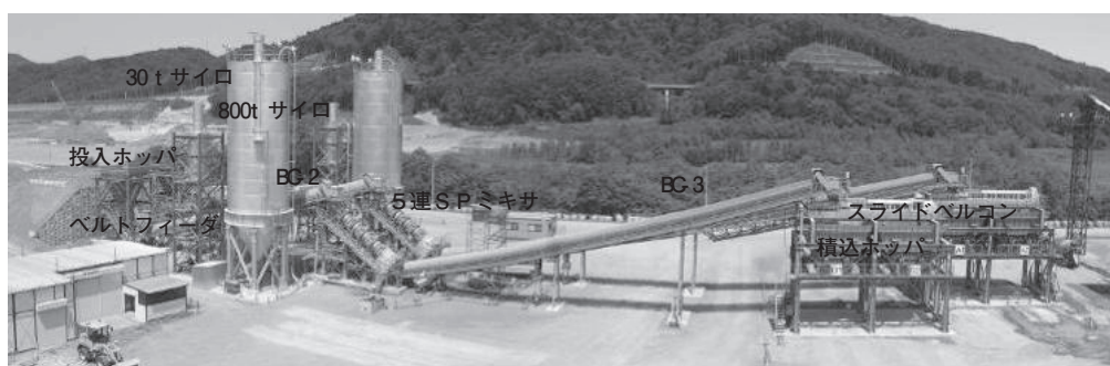
写真一3 当別ダム CSG 製造設備(全景)
