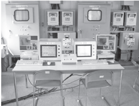
写真一6 CSG 製造総合監視システム
