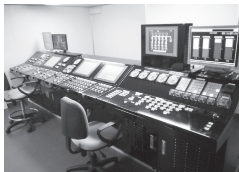
写真—6 機関監視室
