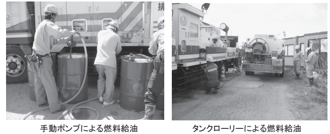
図一九 排水ポンプ車の維持管理
