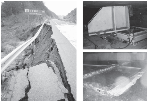
図一 16 高速道路の被災状況 2
