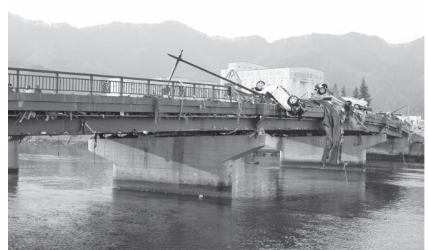
写真—6 津波が上部構造位置を超えたと想定されるが上部構造は流出しなかった橋
