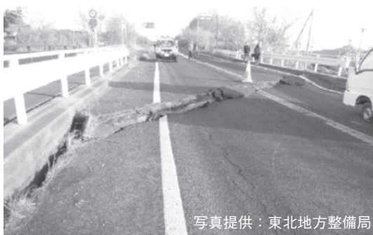
(a) 踏掛版がなく車道部に段差が生じた事例
