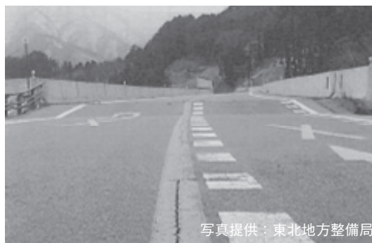
(c) 踏掛版は設置されていたが盛りこぼし橋台の背面土沈下に伴い段差が生じた事例
