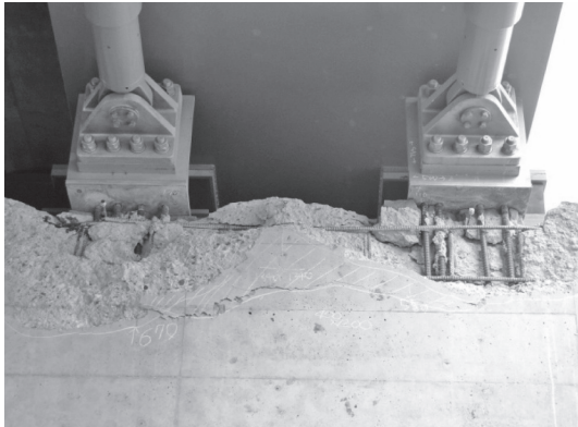
写真-3 制震装置を取り付けた下部構造側の部位に生じた損傷
