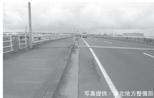
(b) 車道部には踏掛版があるが路肩部で沈下が生じた事例
