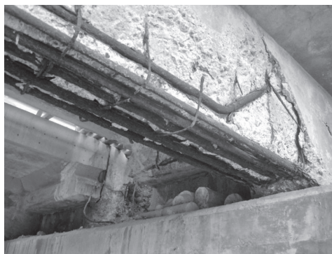
写真—1 RC 橋の塩害劣化
