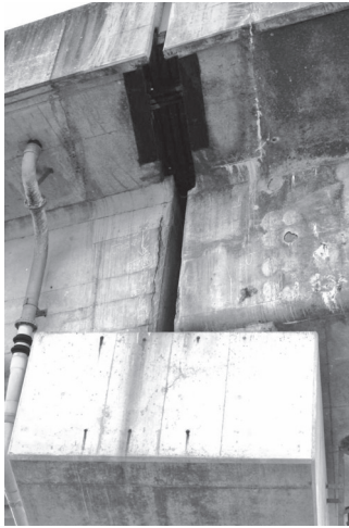
写真一三 ジョイントからの漏水による塩害
