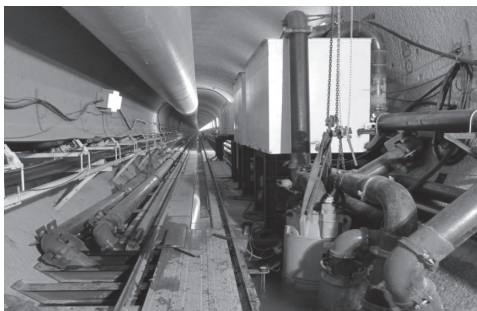
写真—14 TBM-1 坑内排水設備
