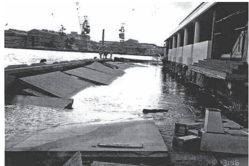
写真-3 埠頭南側岸壁の被害状況
