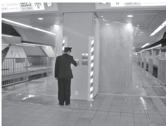
写真—6 地下駅ホーム階の階段下部に設置された本防火設備作動の様子 (京王電鉄新宿駅)
