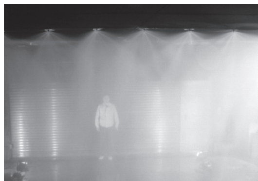
写真—1 本防火設備は水によるシャッター
