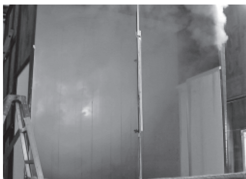
(b) 本防火設備作動中
