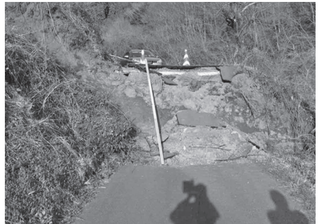
図-1 塩ノ平断層の地盤変状(鉛直方向1.8m) 5)
