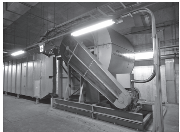
写真—5 トンネル排煙機
