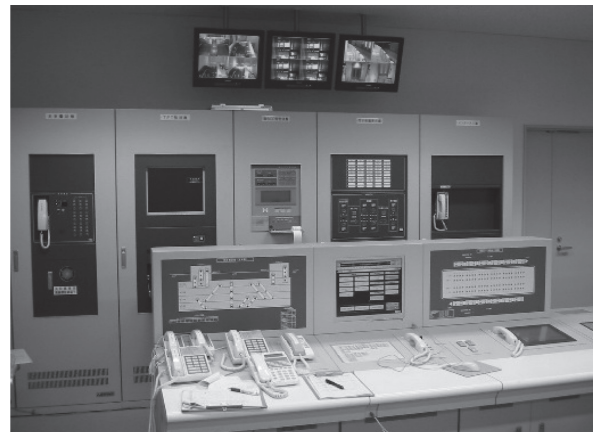
写真一2 防災管理室
