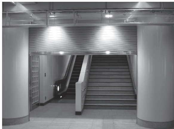
写真—1 ホーム階段の2段降下防煙防火シャッター
