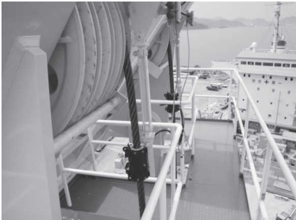
写真一八 ワイヤロープ遠隔監視システム
