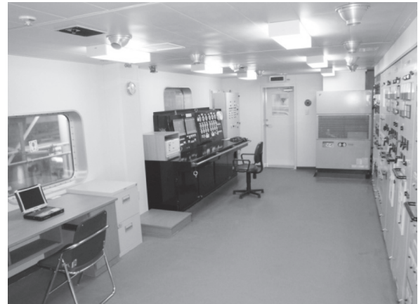
写真一〇 IP カメラ遠隔監視システム（機関制御室を含む 3 箇所にて監視）
