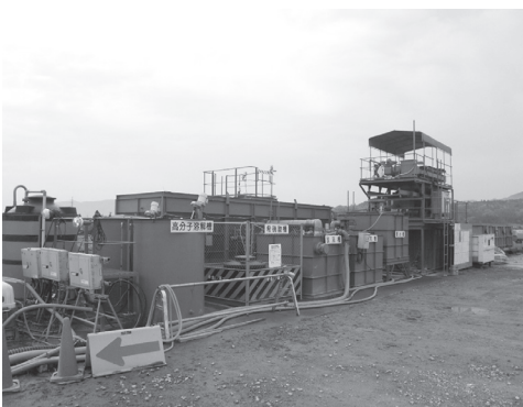
写真—16 濁水処理設備
