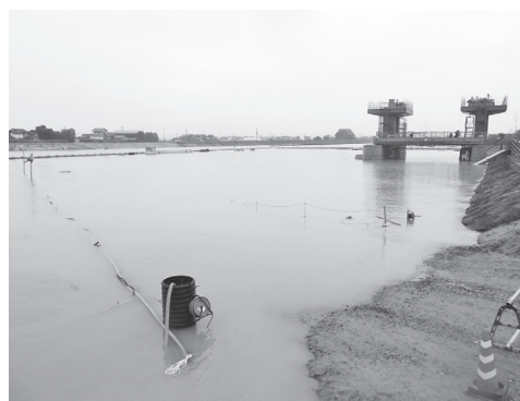
写真-14 仮締切内冠水状況
