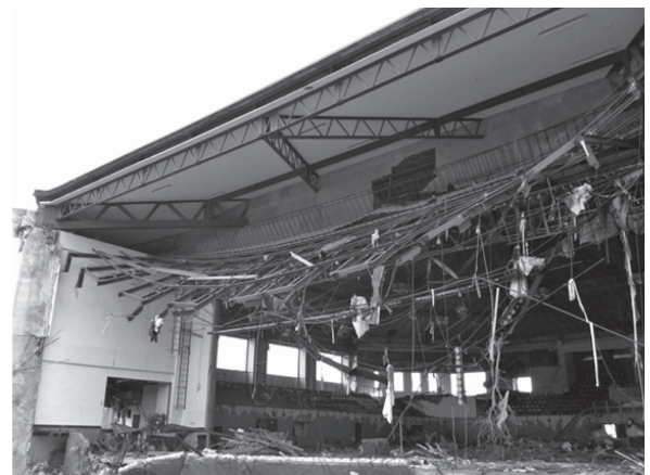
写真-2 鉄筋コンクリート壁の内部からの大規模崩壊
