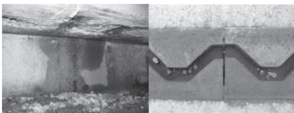
写真—9 伸縮装置からの漏水と止水材の開き
