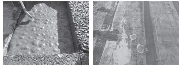
写真一6 防水層に生じたプリスタリング（膨れ剥離）
