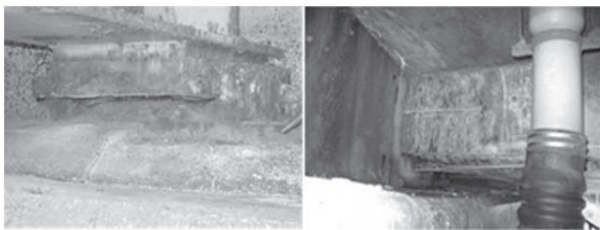
写真—8 伸縮装置からの漏水による桁端の損傷
