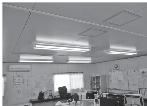
写真一七 現場事務所でのLED照明の使用状況
