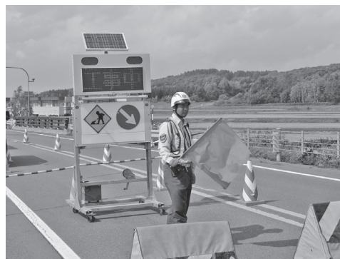
写真一六 ソーラーパネルを利用した電光標識
