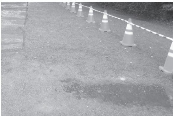
写真—6 神社の参道の施工 水溜り
