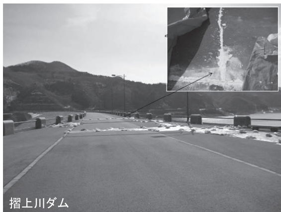
写真-1 ダム天端舗装の小規模なクラックと応急対策
