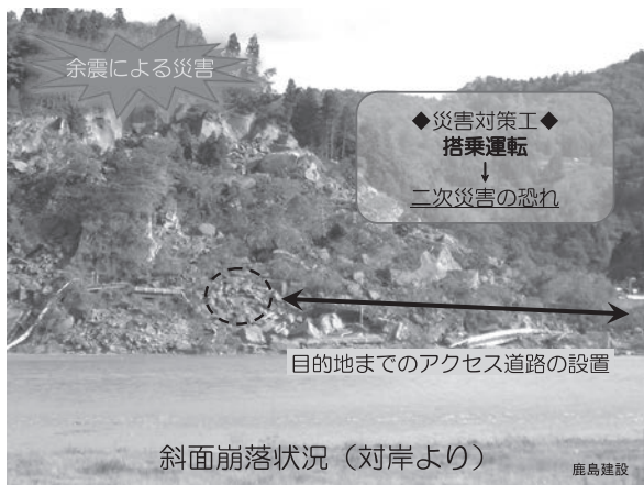
図一30 中越地震による斜面崩落状況
