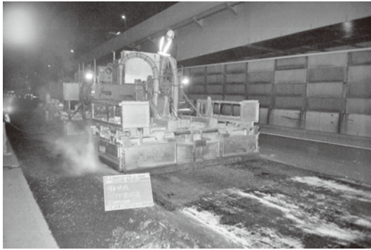
写真一2 路面ヒーター
