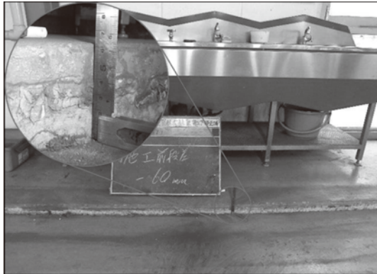
写真一六 施工前 段差 60 mm
