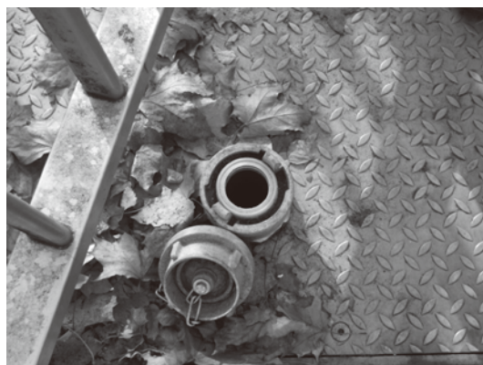
写真一十一 樋洗浄用の注水口 (スイス)
