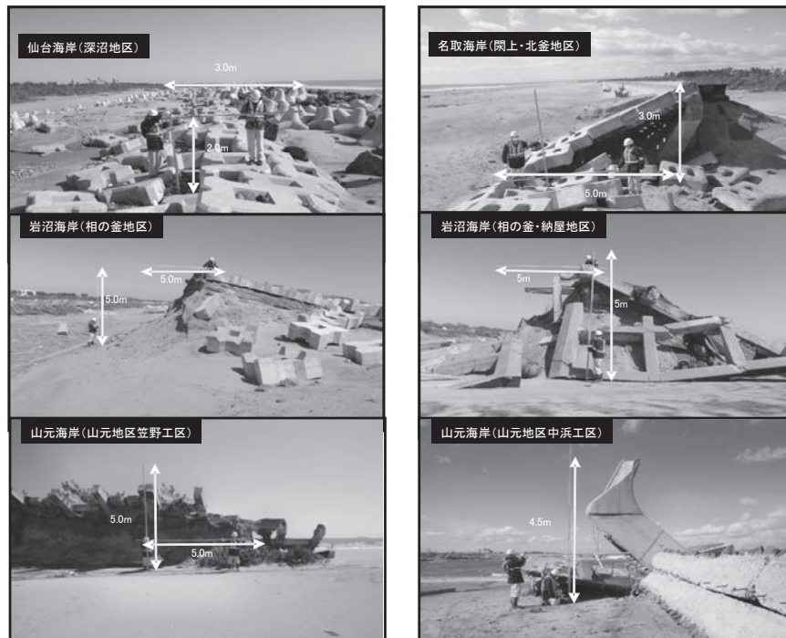
写真—2 海岸保全施設の被災状況
