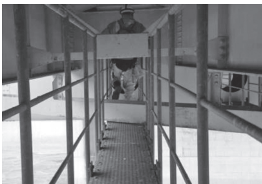
写真一5 部材の干渉により移動に大きな負担を伴う例
