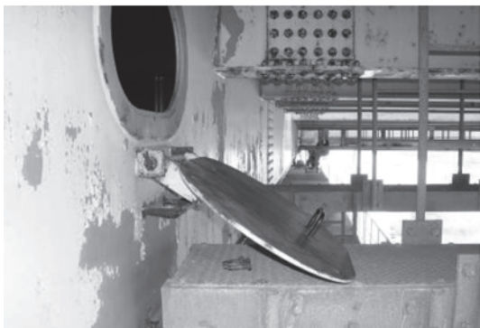
写真一4 鋼製扉の取付の配慮が不十分な例
