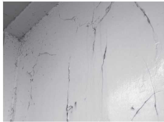
写真—6 塗膜割れの事例
