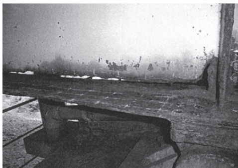
写真—3 鋼桁端部の腐食事例
