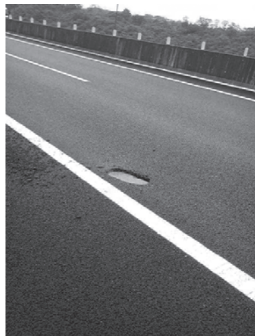
写真—1 舗装への損傷発生事例
