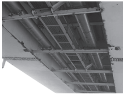
写真一三 ボルト，雨かきのない下フランジが錆びる（三国大橋）
