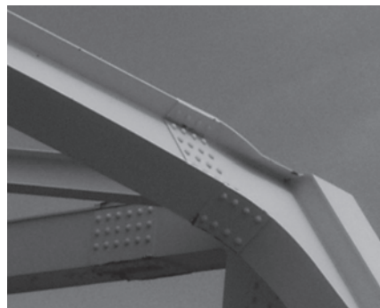
写真—2 写真—1と同じ橋の雨かかりの部分
