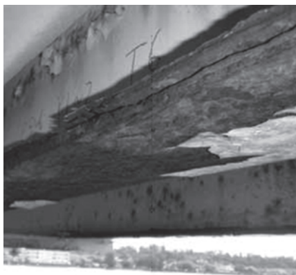
写真—1 河口部の橋桁の腐食
