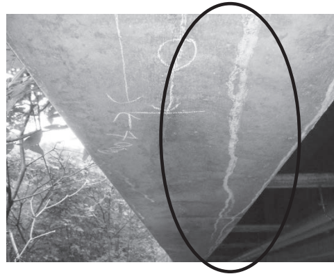
写真-2 桁下の橋軸方向クラック
