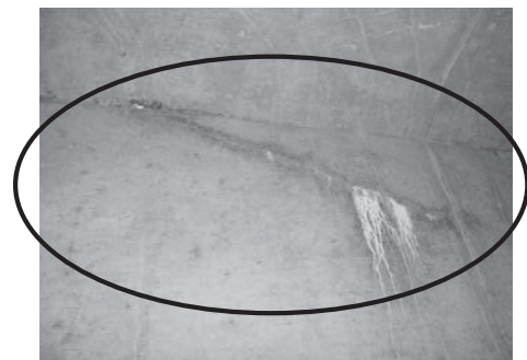
写真-3 橋梁端部クラック
