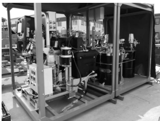
写真—1 ポンプユニット
