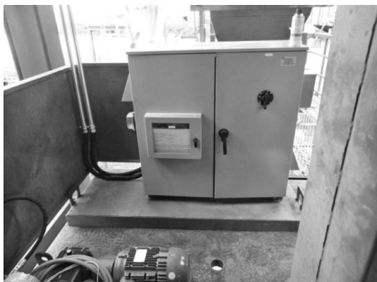
写真一4 水制御装置
