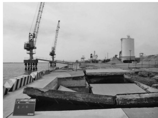
写真-2 被災した 7 号ふ頭岸壁 (先端護岸)
