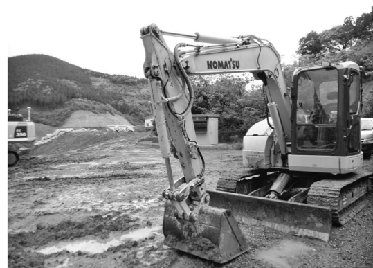
写真－6 システム設置状況（0.25 m³ クラス）
