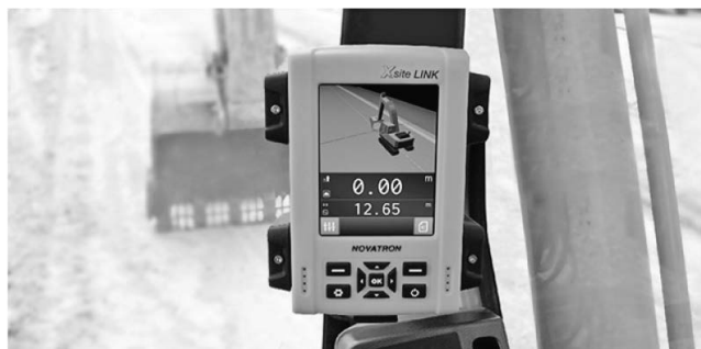
写真-2 キャビン内への設置状況
