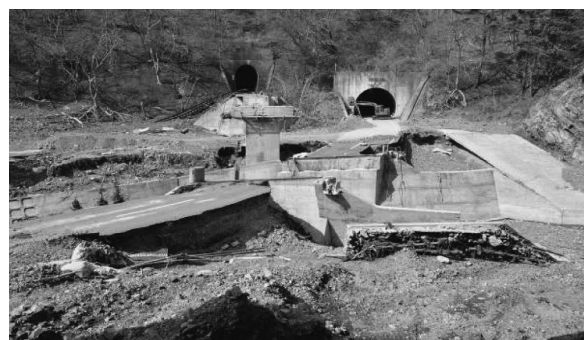
写真-1 ハイペ沢橋梁の被災状況
