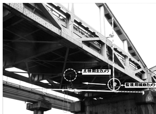
写真四 監視用補助カメラ設置状況
