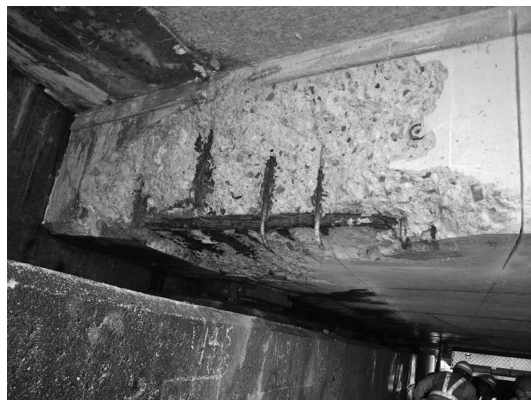
写真－1 劣化写真
