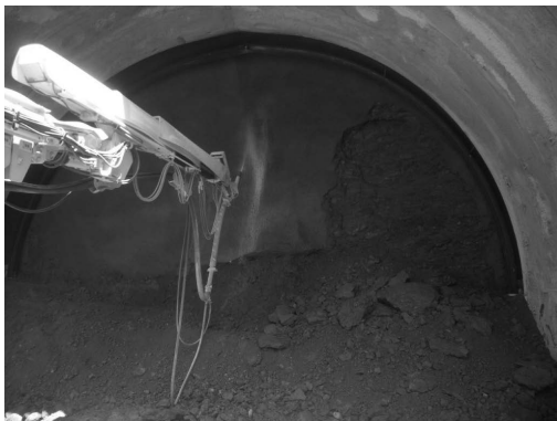
写真―7 崩壊した坑口部の切羽
