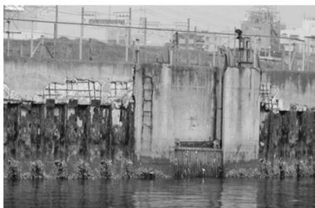
写真—3 鋼矢板の腐食・コンクリートの劣化
