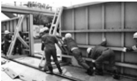
写真—2 陸閘の操作
