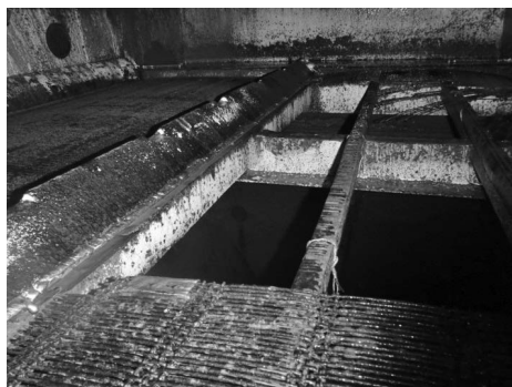
写真-4 一次処理機 振動ふるい網損傷状況
