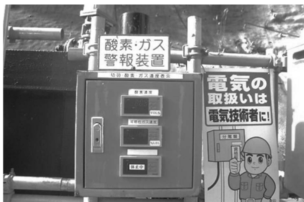
写真—4 坑口部電光掲示板
