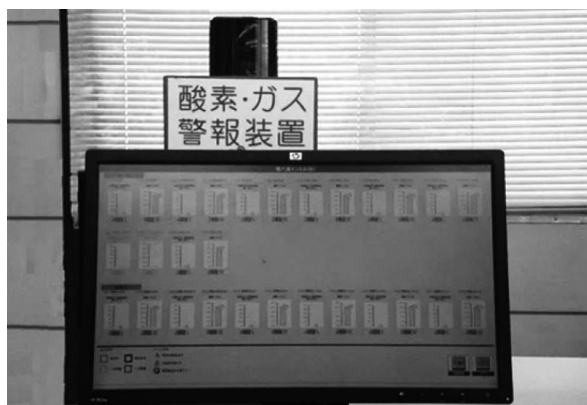
写真—3 現場事務所パソコンモニター
