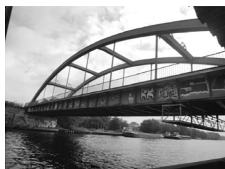
写真—4 無残な鉄道橋の桁
