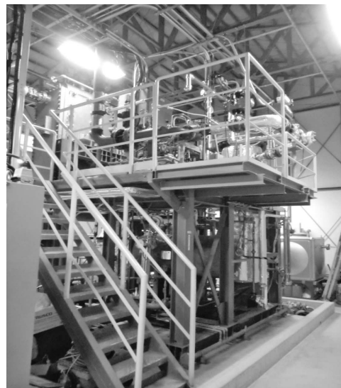
写真—2 実証施設内部の発電システム
