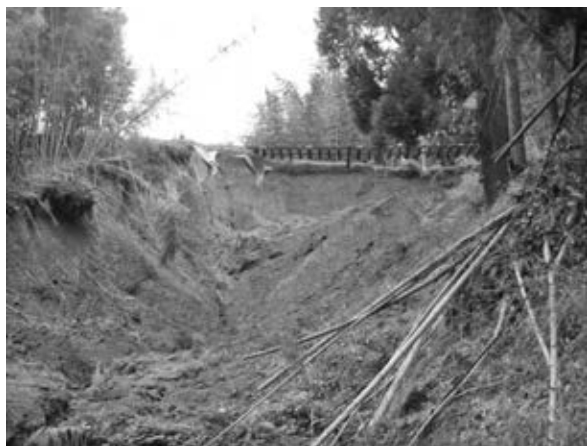
写真一2 被災状況（下方から）
