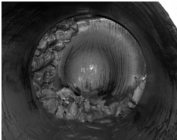
写真—13 中継ポンプ閉塞状況（インペラ吸込み部）
