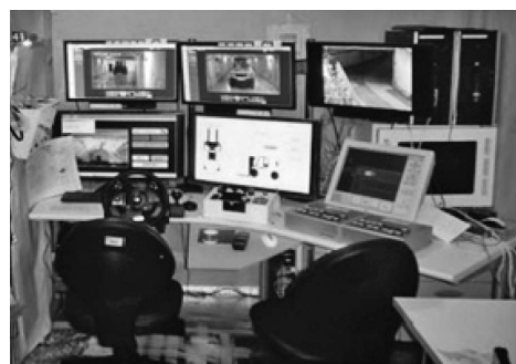
図一8 遠隔オペレータ室
