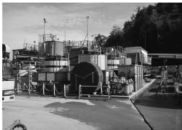
写真—5 濁水処理設備
