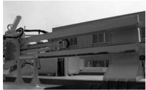
写真 3-132 直列油圧シリンダ方式切換装置 平成 13 年
